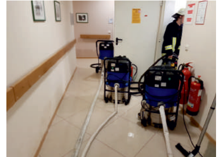
Mehrere „Wassersauger“ waren an der Einsatzstelle erforderlich
